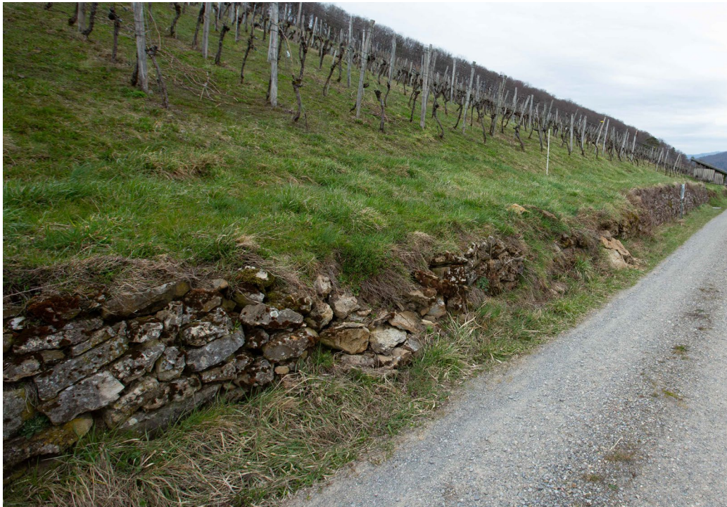
Trockenmauer zwischen Reben und Flurweg, die am Zerfallen ist und saniert werden muss. ©creaNatira GmbH
