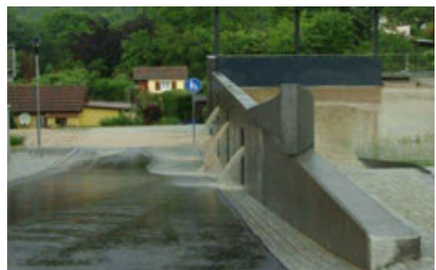
Abb. 80: Ablauf bei Starkregen aus Schlitz in Mauer, mit eingestautem Platz (Quelle: Hauber)
