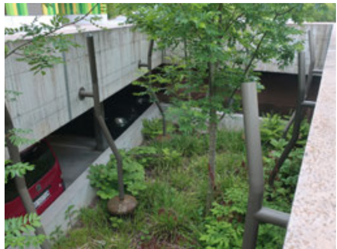
Abb.6 Auspuffähnliche Entwässerungsrohre: mal was anderes!
